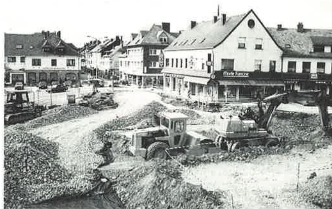
Die Arbeiten am Kreisverkehr „An den Linden“ gehen derzeit zügig voran und sollen vor dem Urlaub abgeschlossen sein.
