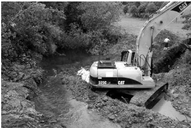
Unter erschwerten Bedingungen verlegten die Arbeiter der Firma Adams aus Meyerode rund 15 m Wasserleitung durch die Our.
