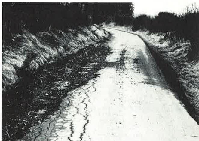
Bedingt durch den strengen Winter sind unsere Straßen stark in Mitleidenschaft gezogen worden (unser Foto). Hier werden zusätzlich nicht eingeplante Belastungen auf den Gemeindehaushalt zukommen !
